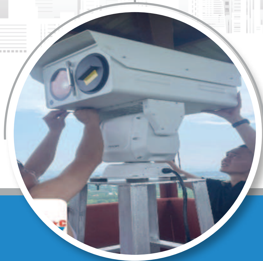
Cung cấp, Lắp đặt hệ thống Camera ảnh nhiệt giám sát cảnh báo cháy rừng trên địa bàn tỉnh Bắc Giang
