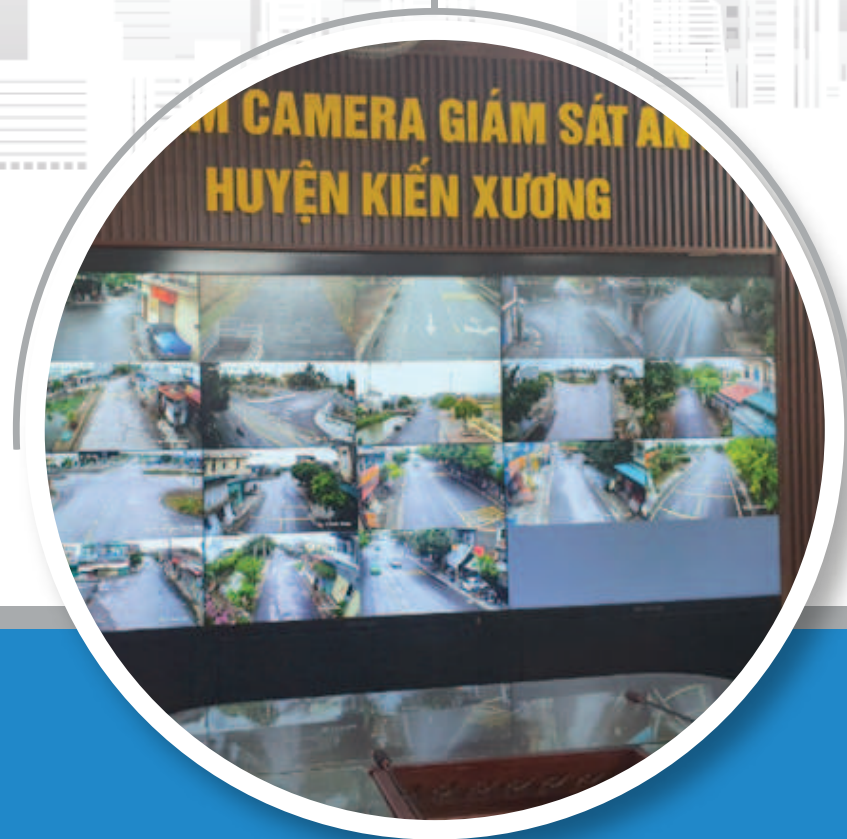
Cung cấp, Lắp đặt hệ thống Camera giám sát an ninh huyện Kiến Xương, tỉnh Thái Bình
